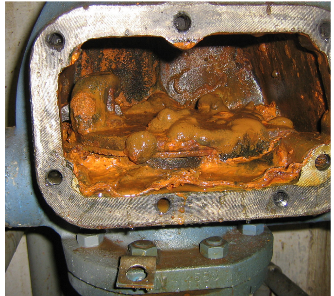
Unterlassene oder nicht fachgerecht durchgeführte Instandhaltungen können zu technischen Fehlern oder zum Versagen im Brandfall führen. Im Bild eine nicht gewartete Ventilstation.
